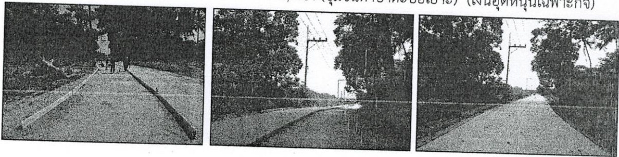
18.โครงการก่อสร้างถนนคอนกรีตเสริมเหล็กใจกลางเมืองตากใบเชื่อมต่อตลาดการค้าชายแดน (ชุมชนบางน้อย - หัวคลอง) (เงินอุดหนุนเฉพาะกิจ)
